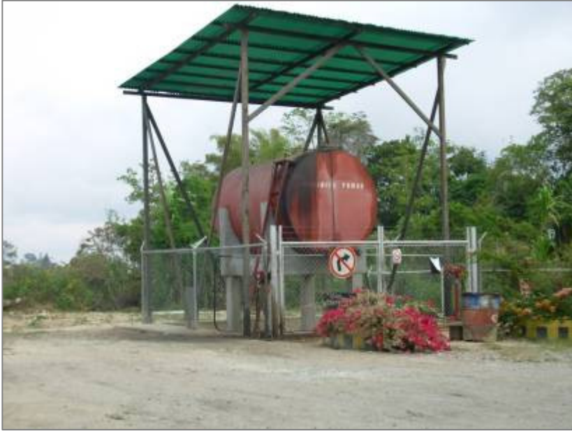
Foto 9. Tanque de aceite de motor ubicado en el depósito / taller de autobuses de la institución
